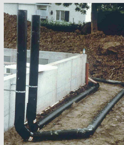
Rys. 69: Ułożenie wymiennika ciepła uzyskiwanego z gruntu w poszerzonym pomieszczeniu roboczym budynku (źródło: Domy pasywne Wegere (CH), CEPHEUS, raport końcowy 2001)
